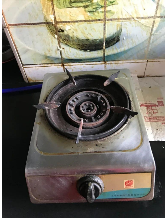
NO.9 遮挡燃气设施
