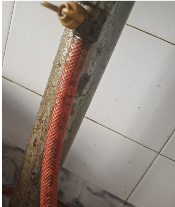
NO.5 气源混用
