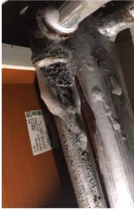
NO.3 管线锈蚀
